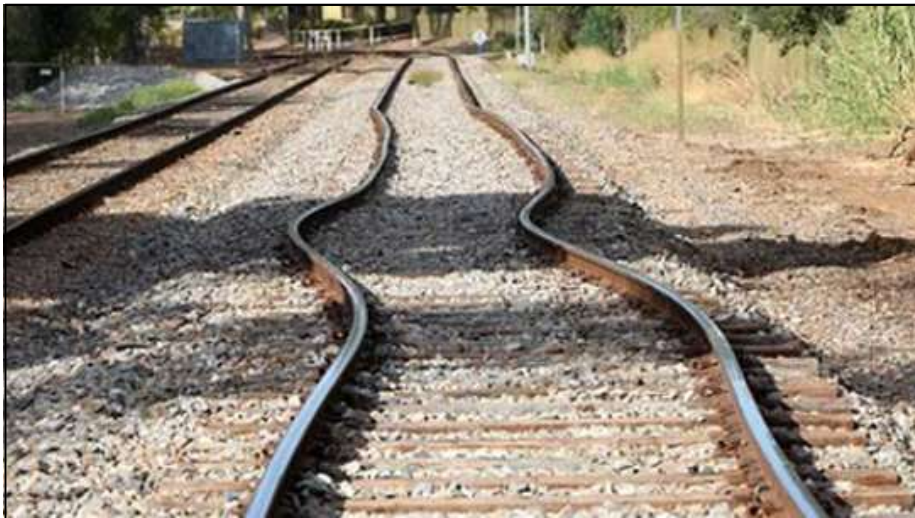
Flambement d'un rail causé par l'élévation de température (Source: MEC 430 Mécanique des Milieux Continus I, Jean-Jacques Marigo, école Polytechnique)
