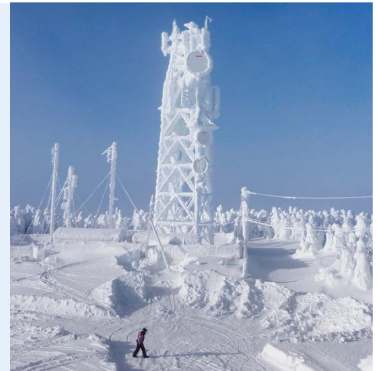
Site de transmission par ondes hertziennes.
