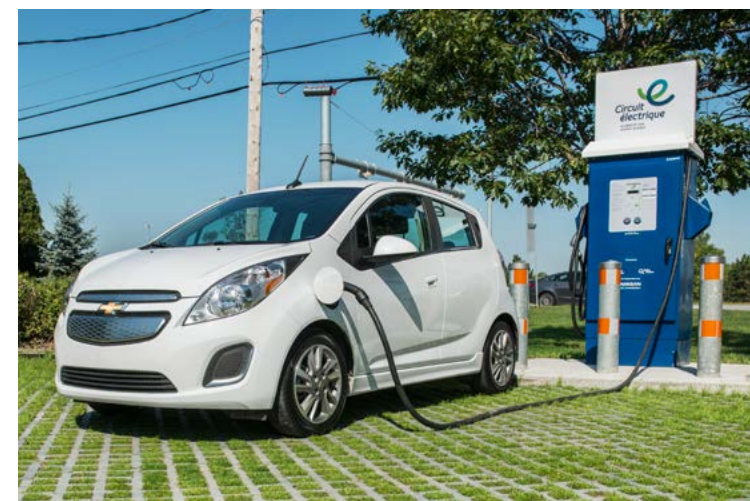
Recharge d'un véhicule à une borne de recharge à 400 V à Sainte-Julie, en Montérégie.
