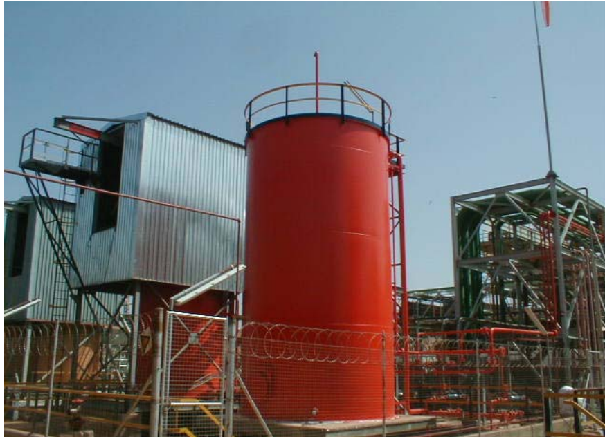
Figure 22 : Cyanuration en cuve, Mine de Sadiola
