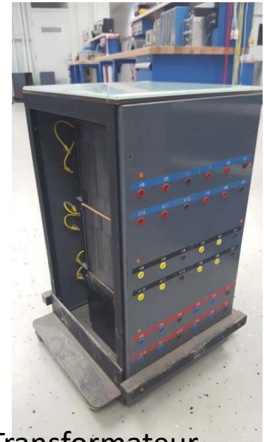
Transformateur triphasé du LAB
