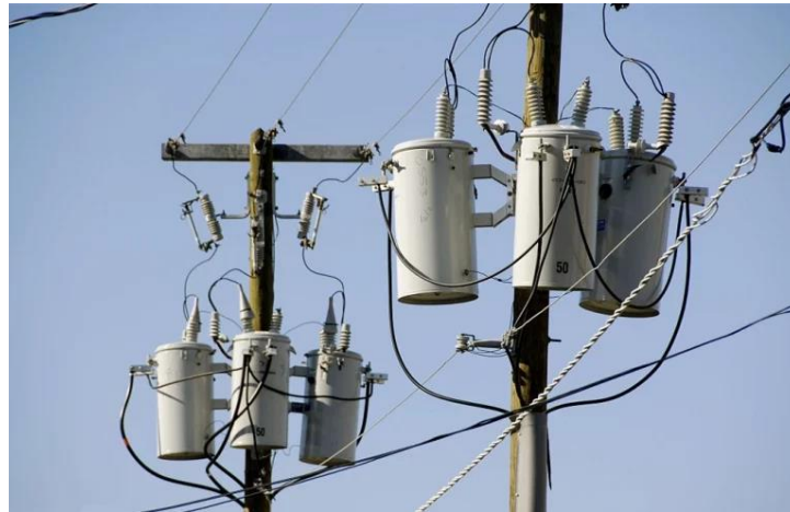
Figure 7. 12. Trio de transformateurs monophasés pour adapter les niveaux de tension d'une ligne triphasée. ( Source ici )
