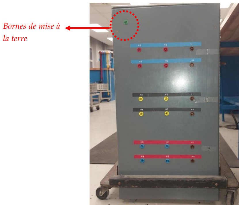
Figure 11. Bornes du primaire (bornes H) du transformateur T7-6 d'HAMMOND
